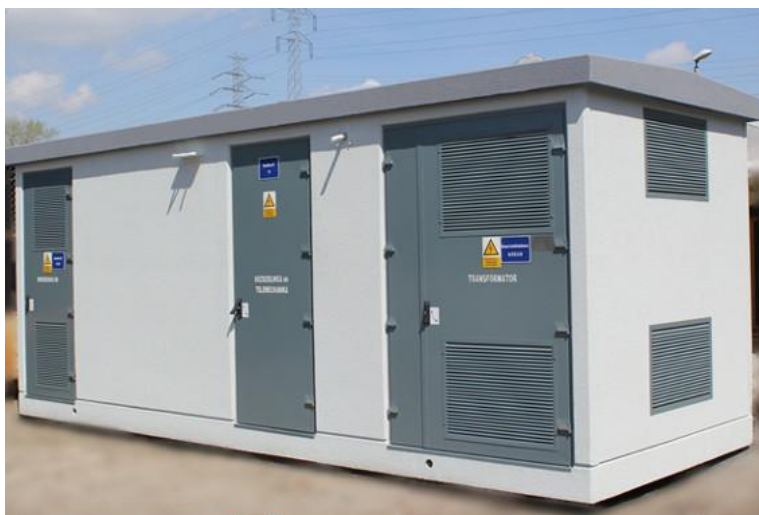
Rys. 3.3. Przykładowa stacja transformatorowa
